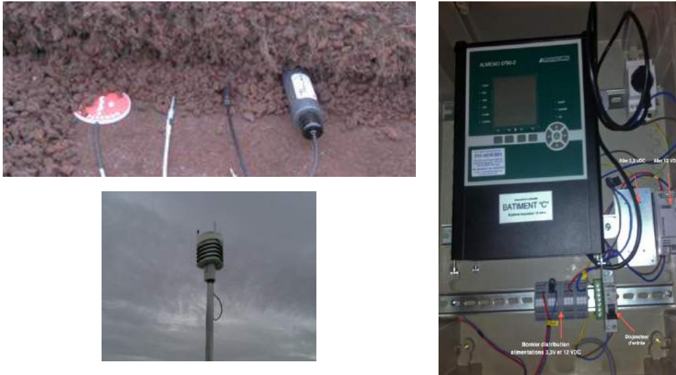
Figure 14 : photo de quelques capteurs et de la centrale d'acquisition utilisés dans le suivi expérimental
